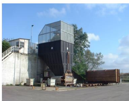
1973 : unité de broyage
